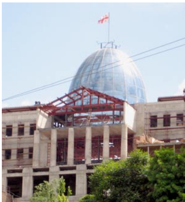
9. L'immeuble en construction de la Présidence de la république de Géorgie. © Photo Gérard-François Dumont - juin 2007.
